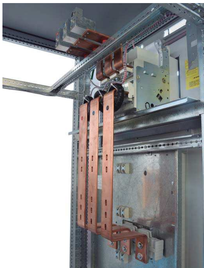
Conexión directa de Megabreak a Bus vertical de distribución sin Bus Horizontal.
